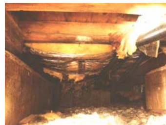
グラスウールのずり落ち事例
